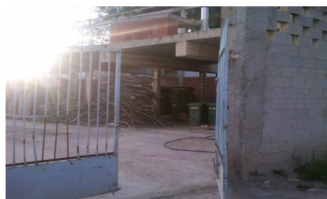
Peligrosa obra de fácil acceso para los más pequeños en el parque
